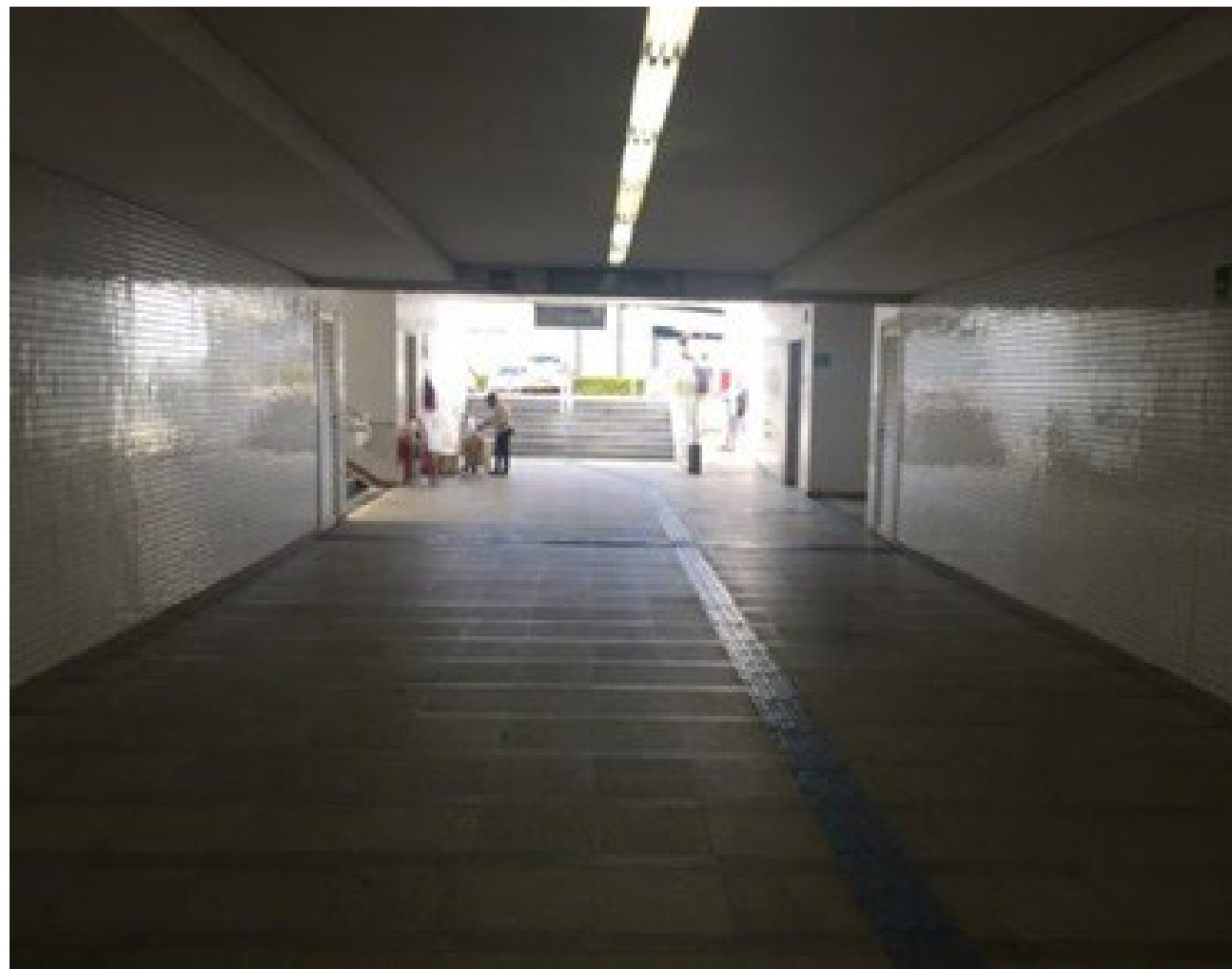
Figura 118. Interior da Estação 112 mostrando sistema de iluminação elétrica difusa.
