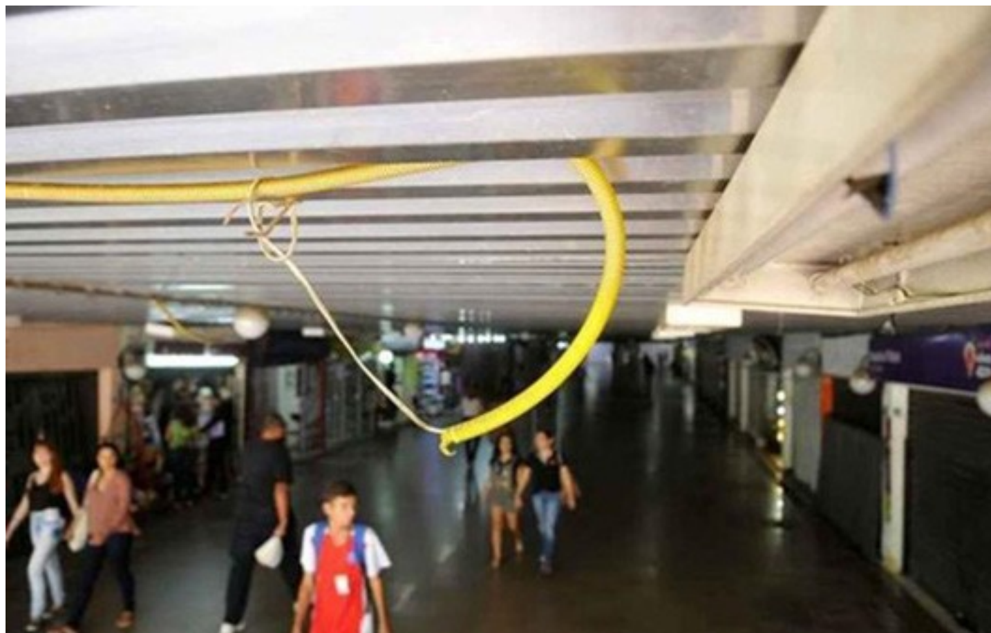
Figura 126. Fotografia demonstrando a falta de manutenção da passagem subterrânea Galeria dos Estados.
