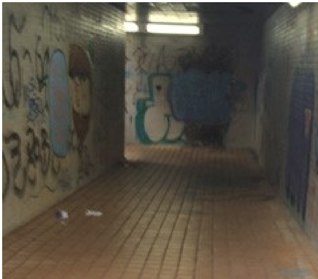
Figura 164. Fotografia da situação 4 mostrando o ambiente desagradável e escuro do interior da passagem.
